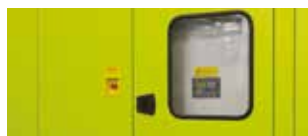
Дверь панели управления (по одной на каждой стороне)
